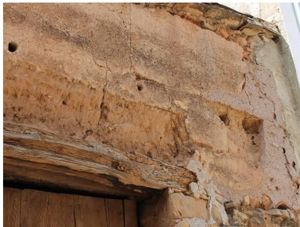
Figura 5. Desprendimiento de costra en una tapia calicostrada con rafas de yeso por acción de agentes ambientales, en progresivo aumento por falta de mantenimiento
